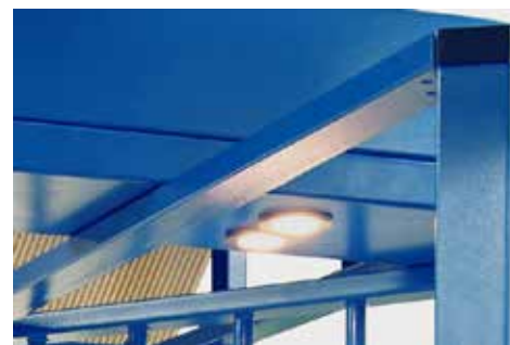
Illuminazione dei passaggi
